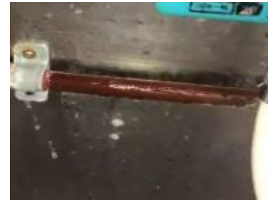
給湯機水漏れ
