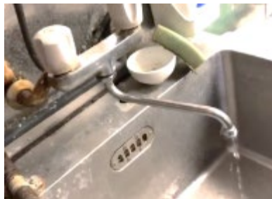
水栓本体 止水不良
