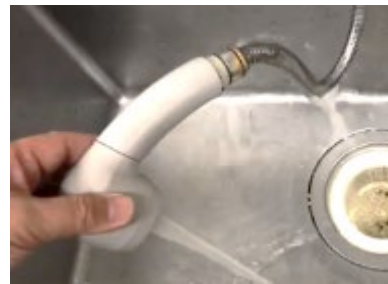
水栓水漏れ・破損
