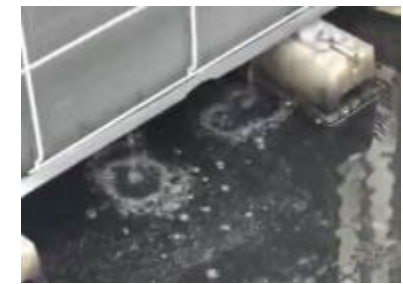
配管系水漏れ
